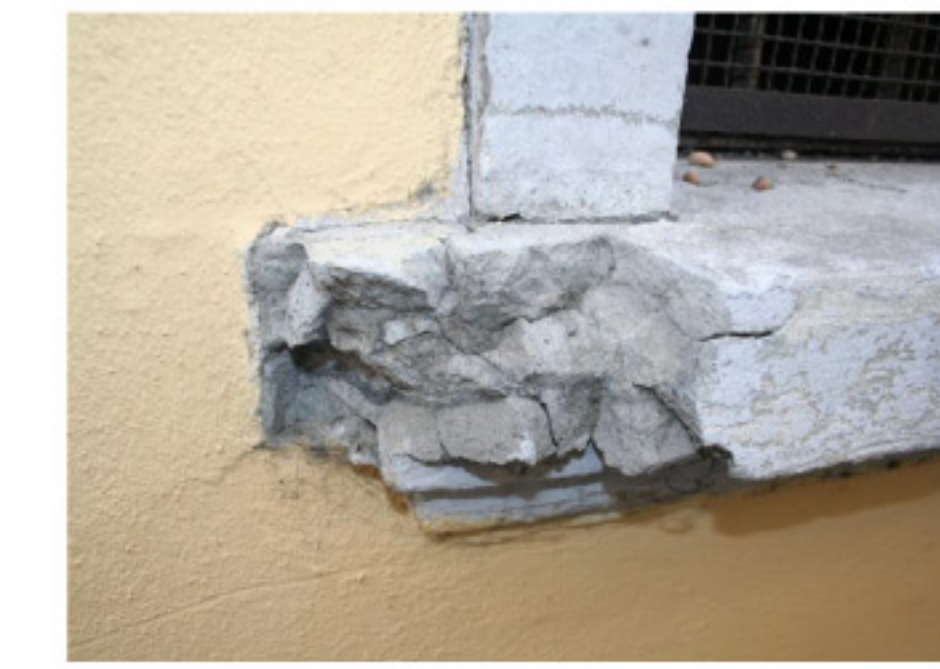
Particolare dei davanzali delle finestre realizzati in cemento lavorato a pié d'opera. Il degrado del materiale, i vari strati di tinteggiature, le stuccature e le ricostruzioni successive, rendono difficile la lettura dell'eventuale lavorazione delle superfici.
