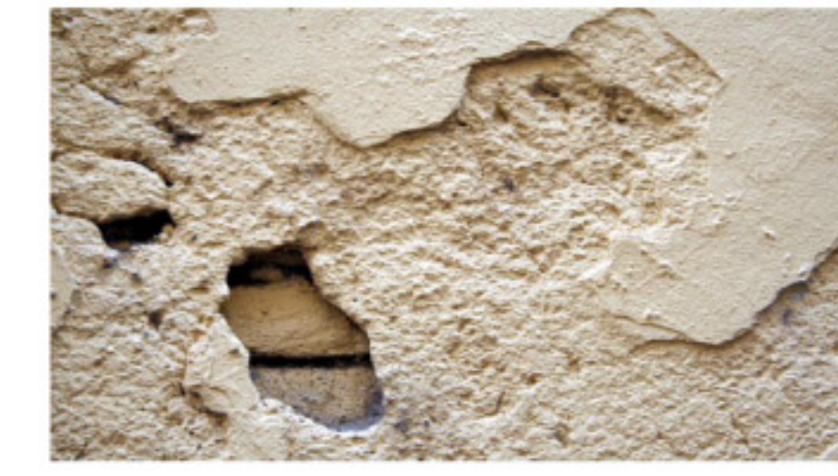
Particolare dell'intonaco realizzato con più strati sovrapposti su muratura in mattoni. Tutto l'intonaco risulta realizzato in più strati dovuti anche a rappezzi, rifacimenti successivi prevalentemente con malta cementizia.
