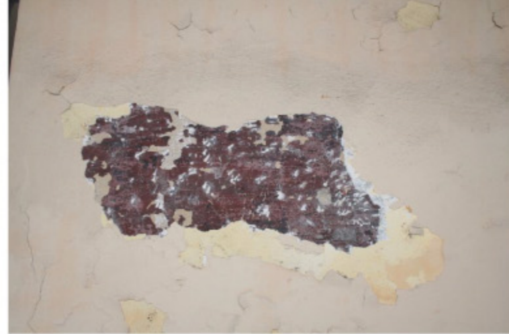
Particolare dell'intonaco realizzato con più strati sovrapposti, dovuti anche a rappazzi, rifacimenti successivi prevalentemente con malta cementizia
