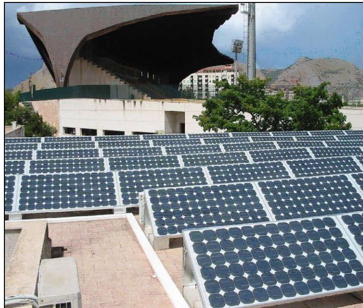
Copertura piana sfruttata al 50% della superficie totale con silicio cristallino
